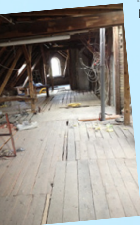
Der alte Dachstuhl war marode.
